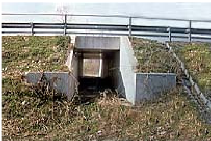
Fig. 5-8 - Esempio di sottopasso rettangolare in cui è necessario inserire fasce di vegetazione laterali che fungano da elementi di invito verso il passaggio- Infra Eco Network Europe
