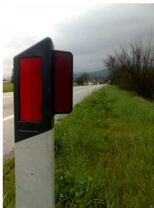
Esempio di installazione di dissuasori ottici
