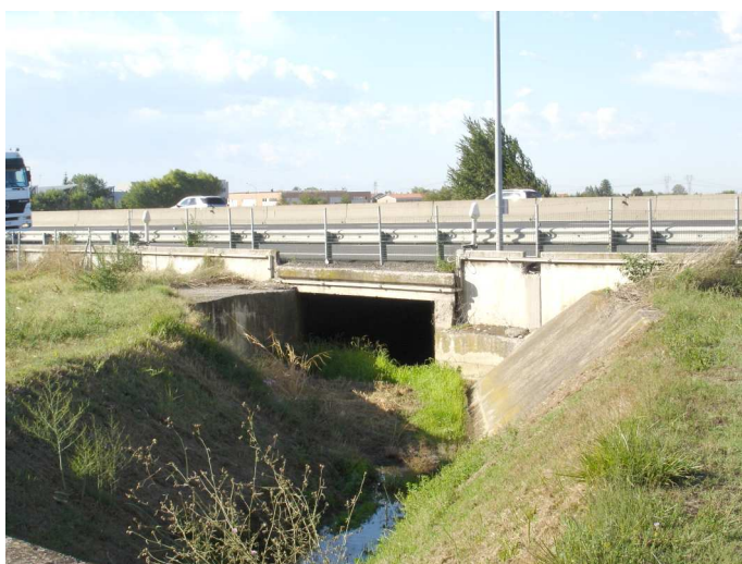
Figura 5-5- Imbocco sud del canale sotterraneo del T. Podice sulla A1. Dimensioni: circa 4 m di ampiezza per 1,5 m di altezza.
