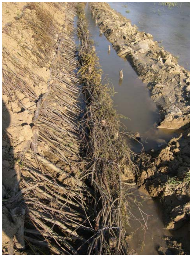
Figura 2.7 - Esempio di copertura diffusa con ramaglia viva applicata lungo le sponde della parte terminale del Fiume Uso (RN)
